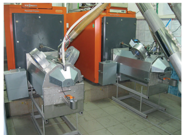
Kotły Viessman Simplex z palnikami Uni-Max Perfect 300kW
