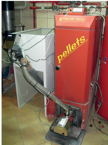
Kocioł na paliwo stałe Kielar z palnikiem Uni 32kW
