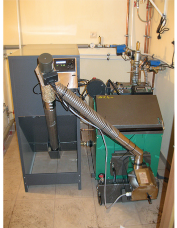
Kocioł na paliwo stałe Moderator-Unica z palnikiem Uni 25kW
